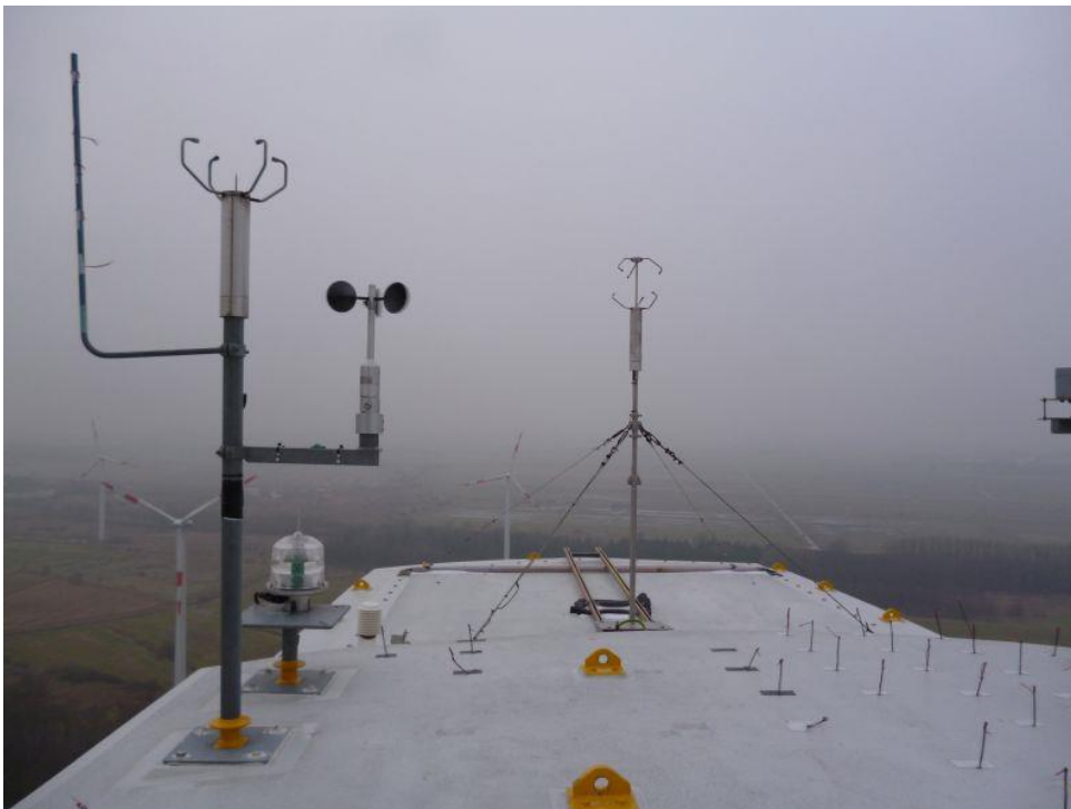
Abbildung 11: Vollständiger Messaufbau im rotorabgewandten Bereich der Gondel mit (von links) Gondelanemometer, Referenzanemometer (v_cup_Ref) und Prüfanemometer (v_usa_DWG).
