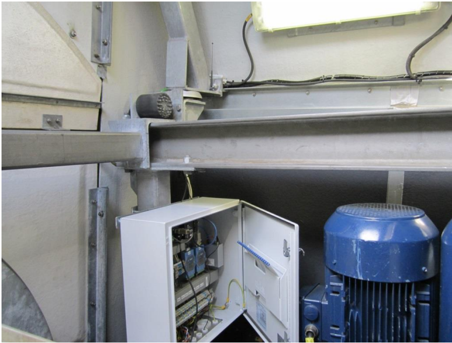
Abbildung 16: Installationsort des Datenloggers im Inneren einer Testanlage.
